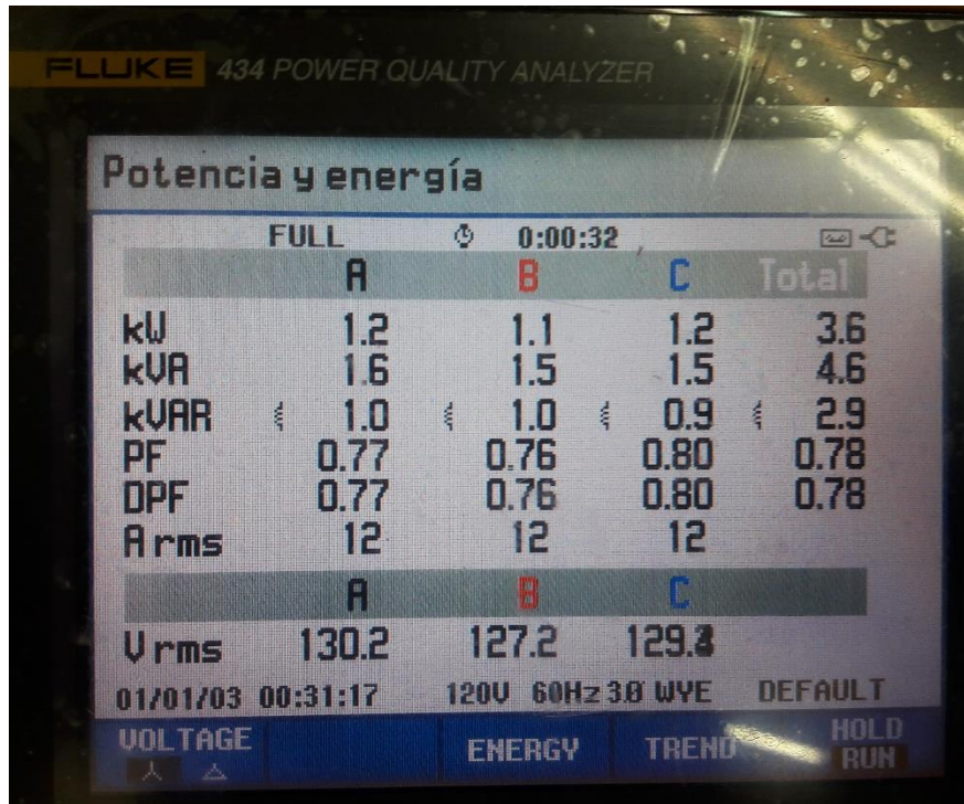
Figura 4.3 Medición de potencias en Fluke 434.
