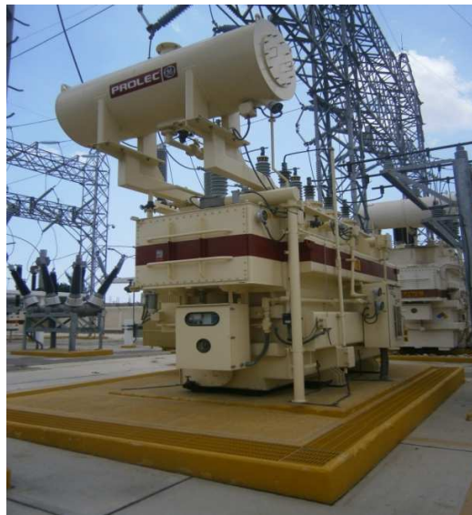
Figura 2.4 Transformador de potencia de una subestación de distribución.
