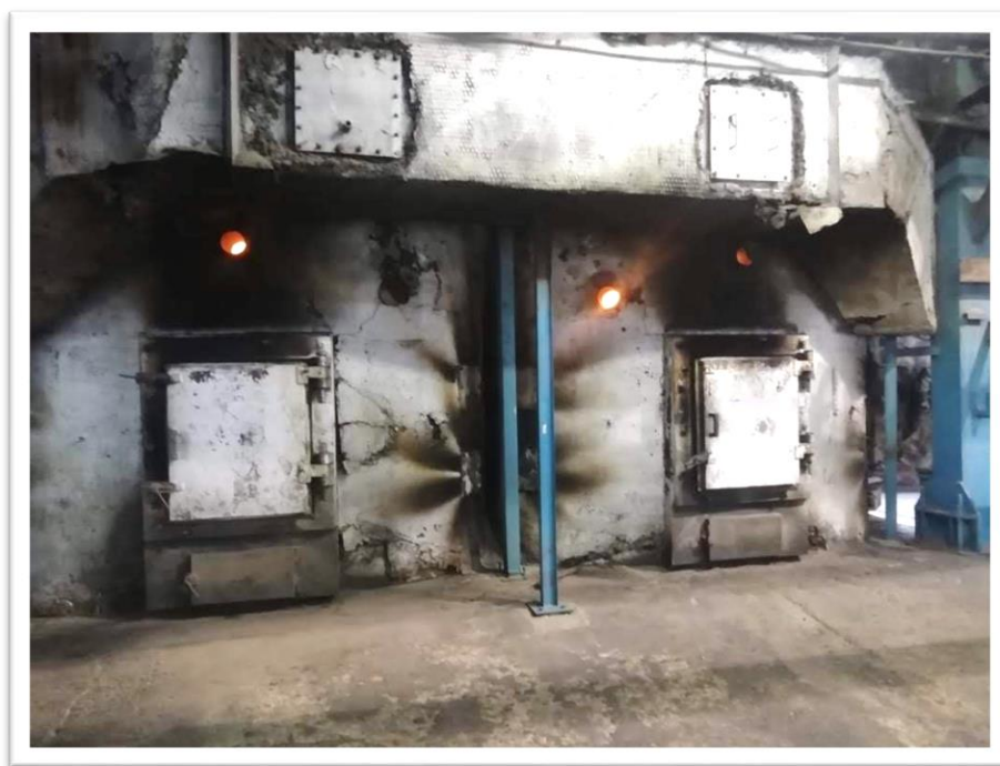
Figura 2. 30 Calderas del ingenio azucarero "El modelo" (Autor propio)
