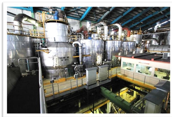
Figura 2. 36 Calderas (Autor propio)
