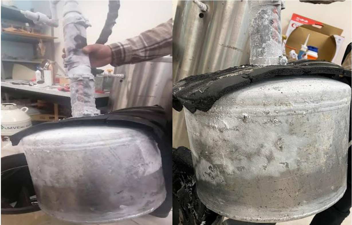
Figura 3.34. Tanque modulator después de realizar las pruebas de funcionamiento del sistema
