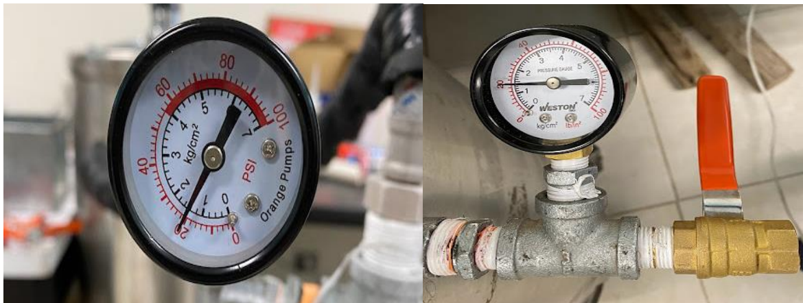
Figura 3.33. Manómetros durante las pruebas de funcionamiento
