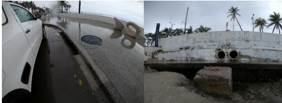
Figura 17. Fuentes Difusas con escurrimiento de agua de lluvia, ubicadas en el Bulevar Manuel Ávila Camacho.
