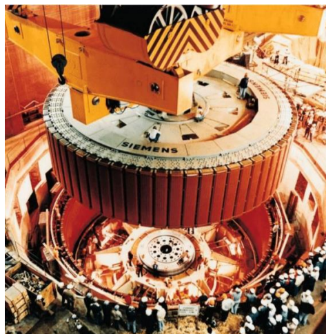
Figura 138. Hidrogenerador trifásico de la central de Itaipú (824 MVA, 90 rpm, 60 Hz)
