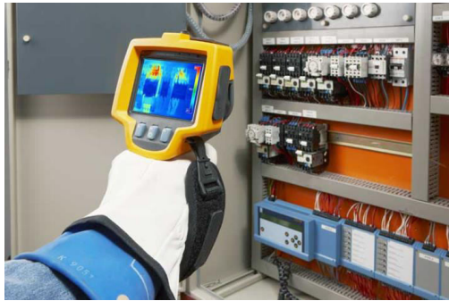
Figura 2-11. Captura de imagen térmica de un tablero eléctrico.
