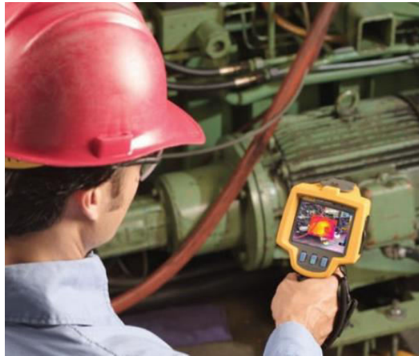
Figura 2-10. Captura remota de una imagen térmica de un motor.
