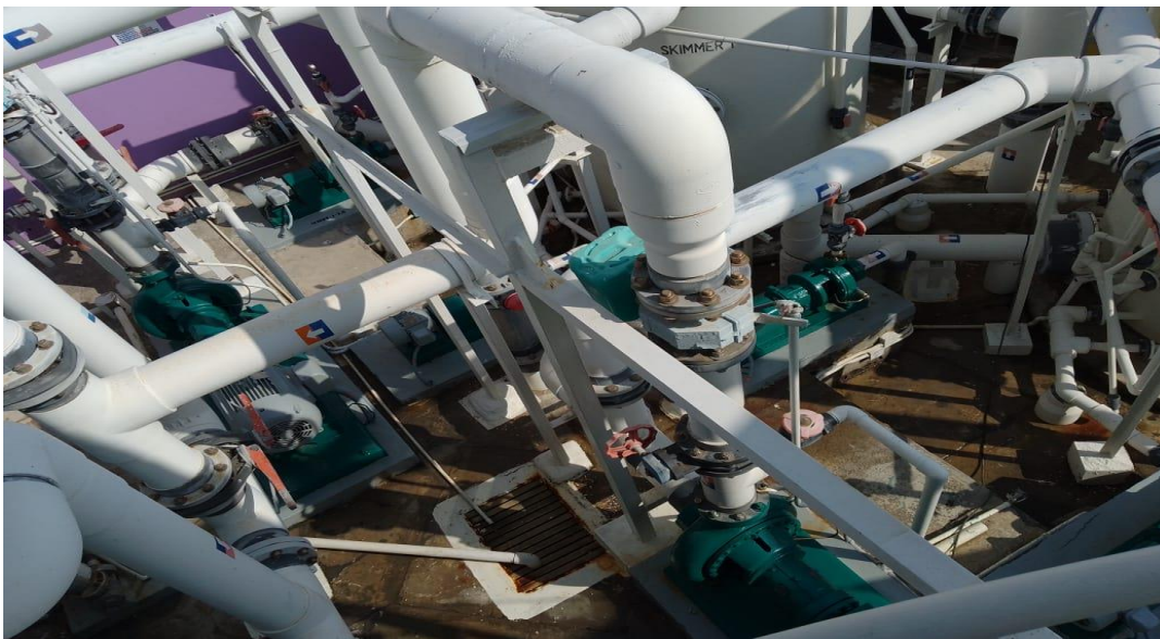
Figura 8: Bombas centrífugas del Aquarium.
