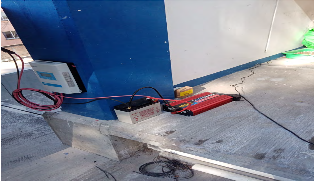
Figura 4.15: Controlador, batería e inversor de corriente.
