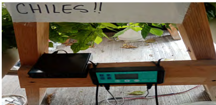
Figura 4.12: Controlador y batería
