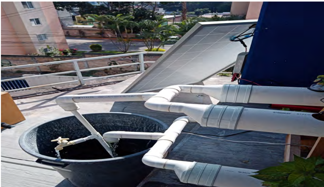
Figura 4.16: Funcionamiento del sistema con el panel solar
