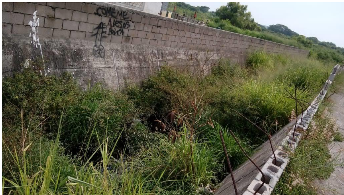
Anexo I. Canal de aguas residuales en pésimas condiciones.
